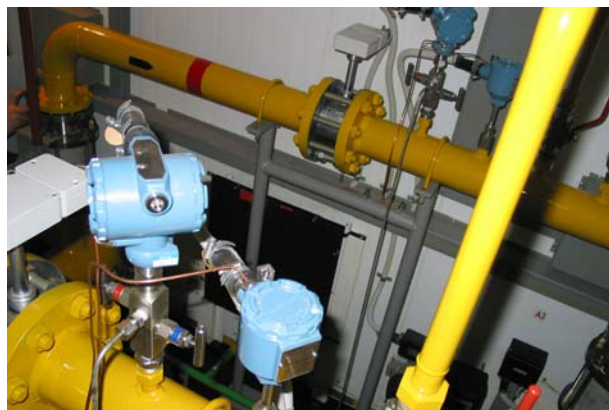
УЗЕЛ УЧЕТА ГАЗА. ВИД ВНУТРИ
